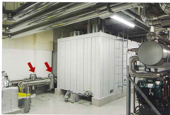
冷却水タンクと冷凍機。タンク内の水が冷凍機に送られて冷却された後、貯蔵タンクへと送られる。冷却水タンクの入口にストレーナーが設置されている。
