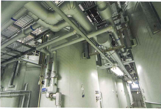
貯蔵棟内に並ぶ貯蔵タンク。タンクの外周には冷却水が流れる配管が敷設されている。酒は瓶詰めの前に、ここで半年から1年程度、精緻な温度コントロールの下に熟成される。
